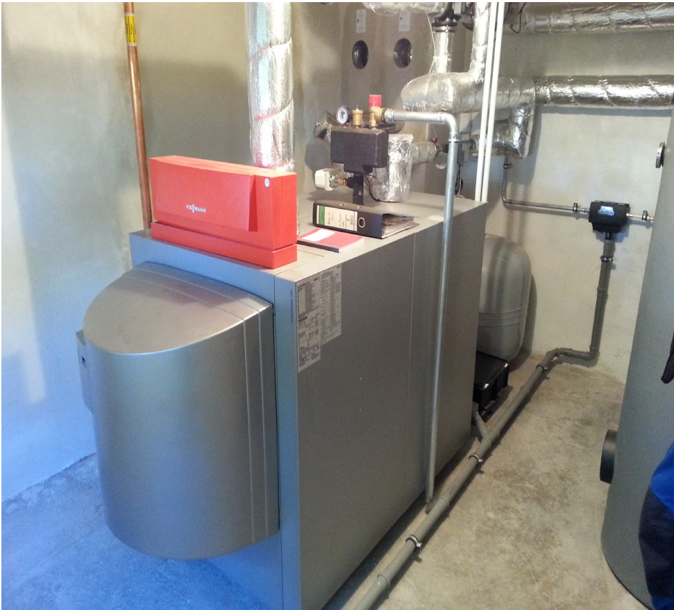
Zentrale Wärmeversorgungsanlage nach Sanierung
